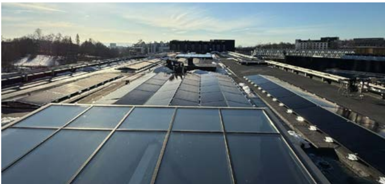
Solcelleanlegget på taket av Ole-Johan Dahls hus er i full drift.
