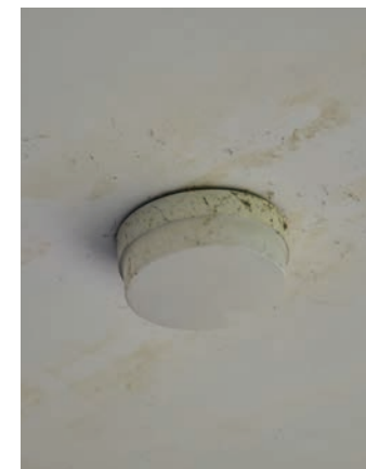
Fastmonterte elementer som belysning kan ikke fjernes uten tillatelse fra Eiendomsavdelingen.
