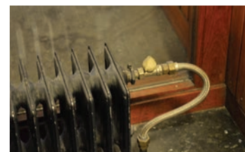
Radiator ved vindu
