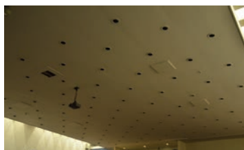
Nedsenket himling med innfelt belysning.
