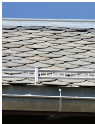
Ødelagte enkeltstein kan skiftes ut med tilsvarende som eksisterende.
