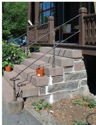
Fugene på trapper og grunnmur kan repareres med mørtel tilsvarende eksisterende. Tilse at mørtelen får lik farge og overflate som eksisterende.
