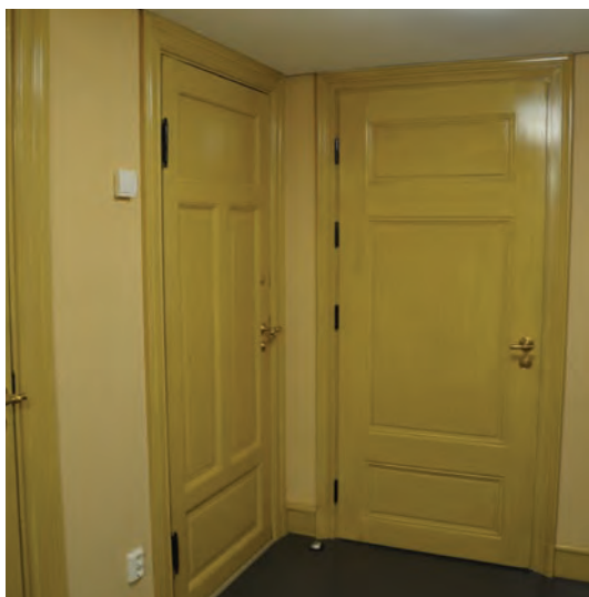
Korridoren har pussete og malte vegger og nytt linoleumsgulv. Døren til høyre går til den åpne korridoren, og er fra 2012. Døren til kottet under trappen er fra 1880–1900.
