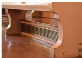
Ventilasjonsrist av messing på undersiden av auditoriumsbenkene.
