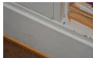
Sokkelen på det bevarte skapet. Nyere vaskelist nederst
