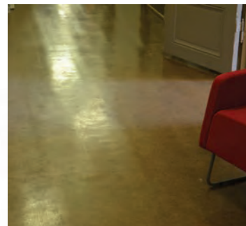
Gulvet er belagt med eldre linoleum. De gamle gulvbordene sees under belegget.
