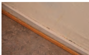
Gulvet er belagt med nyere linoleum og har nyere, glatt fotlist og smal vaskelist.
