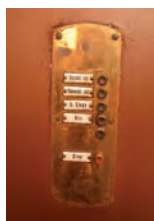
Eldre styringspanel til heisen
