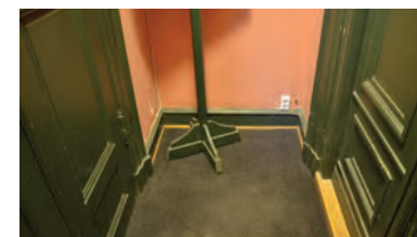
Gulvet i vindfanget
