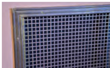
Ventilasjonsrist på den bakre veggen
