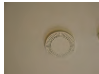
Ventilasjon fra himlingen
