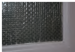
Den eldre døren mellom trapperom og kontor 270A har et felt av tråd-glass i dørbladet.
