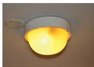
Nyere plafond på dametoalettet
