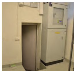
Døren til trapperommet. Teknisk skap til høyre
