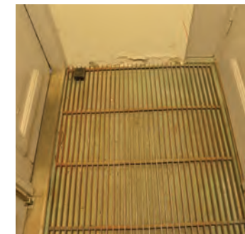
Gulvet i vindfanget
