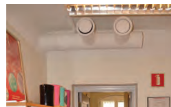
Nyere rørføringer til ventilasjon
