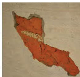
Skade på veggen må utbedres.
