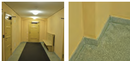
Dør fra 1995 inn til kantinen. Dør til venstre er fra ca. 1910. Veggene er pusset og malt, gulvet er av terrazzo.
