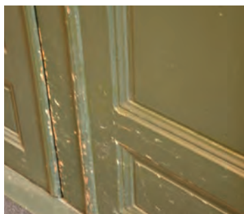
Nedre del av dørbladet på den eldre døren ut til vindfanget.
