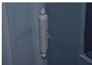
Eldre hengsler på dør mot trappe-rom
