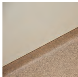
Malte vegger og nyere belegg på gulvet.
