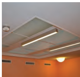
Nyere lysarmaturer i himling kledd med akustiske plater.
