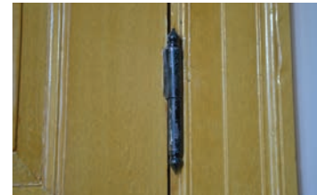
Detalj av eldre dør, hengsel og gerikt til HC-toalettet. Malt med linoljemaling.
