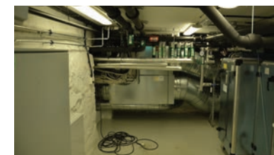
Nyere lysarmatur i himlingen, sammen med diverse rørføringer
