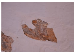
Maling og puss har flasset av teglveggen.
