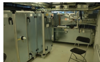
Rommene er fylt med diverse tekniske installasjoner.
