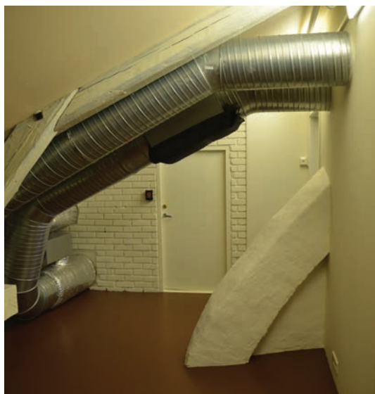
Deler av eldre, trukket pipeløp og bjelker er synlige mellom nyere vegger og himlingsplater.
