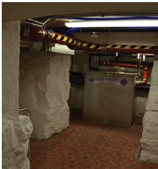
Rom 010 med nyere teknisk anlegg og belysning
