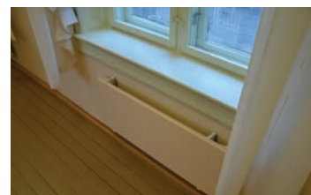
Nyere radiatorer under vinduene
