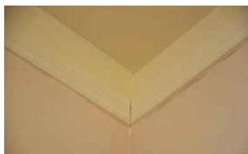
Den originale taklisten er trolig av trukket gips, kan være i kombinasjon med en profilert trelist som i de opprinnelige stuene.
