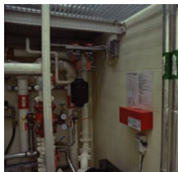
Teknisk utstyr i rom 105
