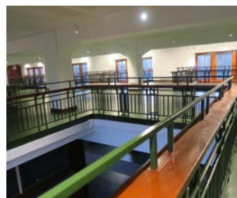
Det er åpent ned til 2. etasje. Den øverste delen av rekkverket er nytt.
