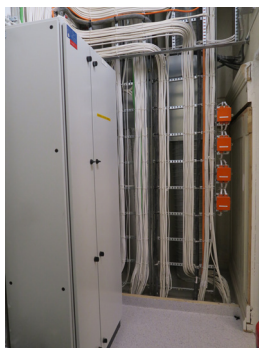
Rom 113 med teknisk utstyr.
