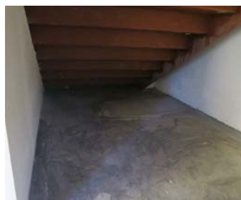
Rom 267, på undersiden av trappen.
