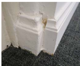
Overgang mellom opprinnelig og ny fotlist.
