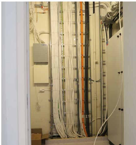
Nytt teknisk rom sett fra utstillingssal 192.
