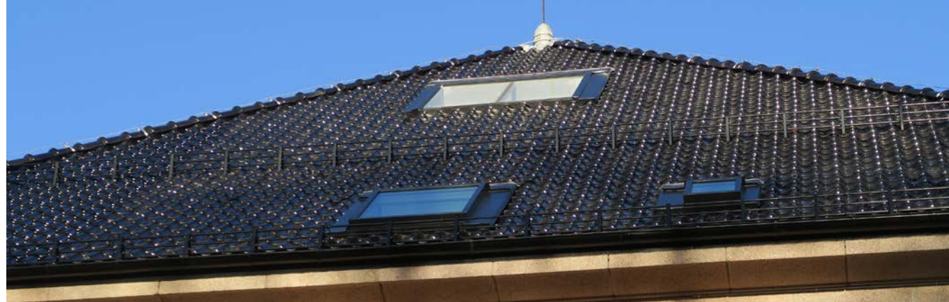
Nyere takteking og snøfangere. Flere nyere takvinduer.
