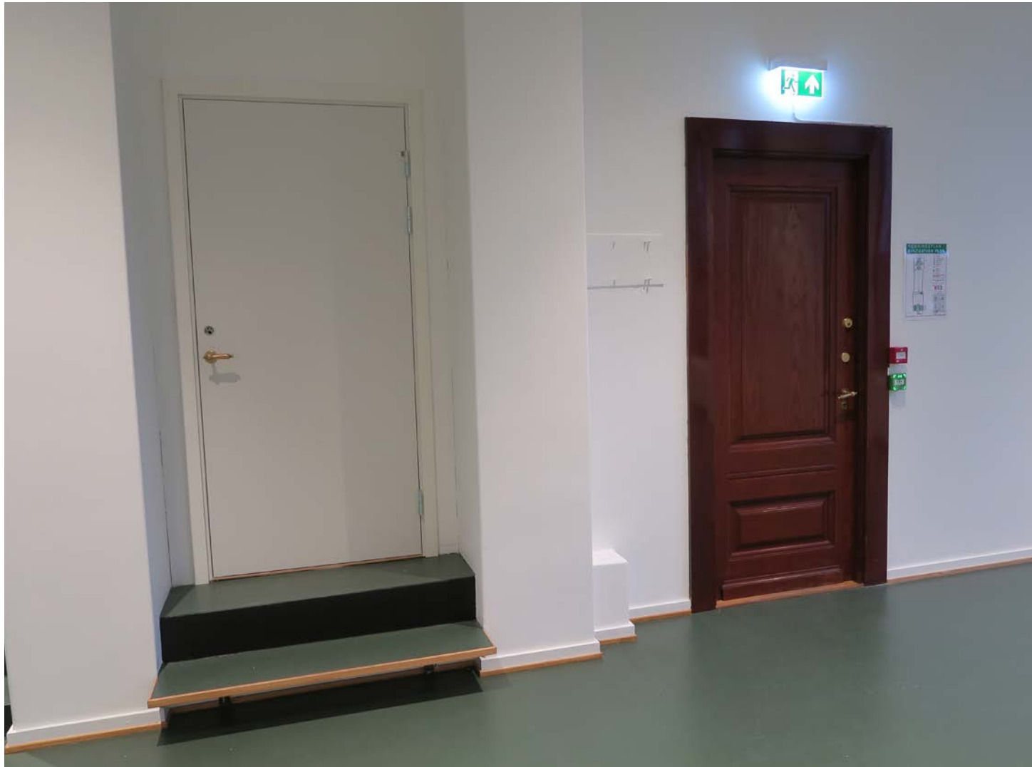
Nyere, hvitmalt dør til venstre til teknisk rom 191. Opprinnelig fyllingsdør til høyre til trapperom 162.
