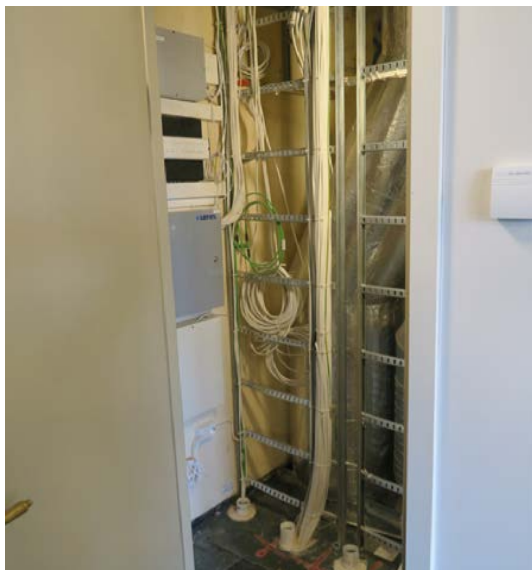
Rom 206, teknisk rom.
