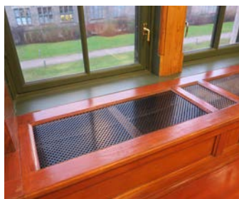
Radiatorskjuler, med netting av metall over.
